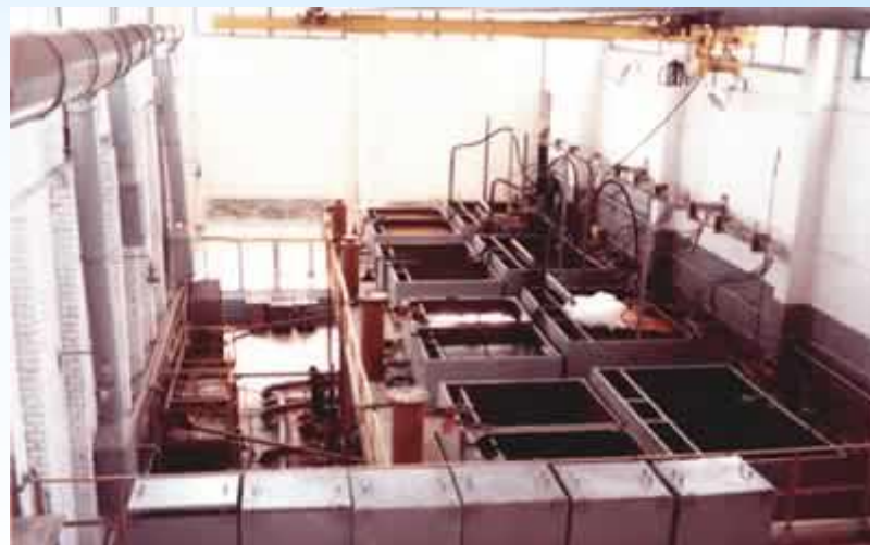
• Станция нейтрализации сточных вод
